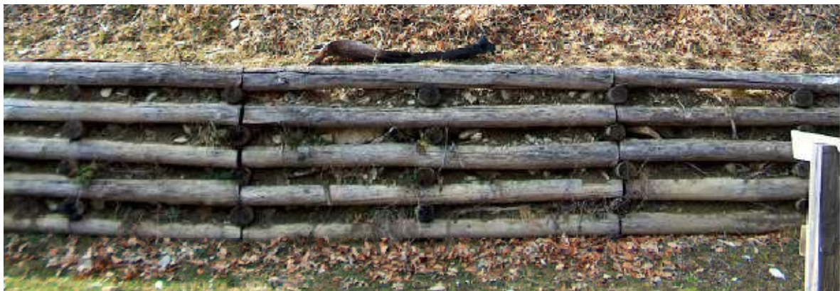
Foto 7.1.a – Frecuentes errores en la realización de un entramado de pared doble: falta de material vegetal vivo; travesaños y puntos de uniones de los listones alineados en vertical
